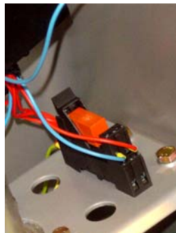
Thermischer Schutzschalter: Ausgelöst
